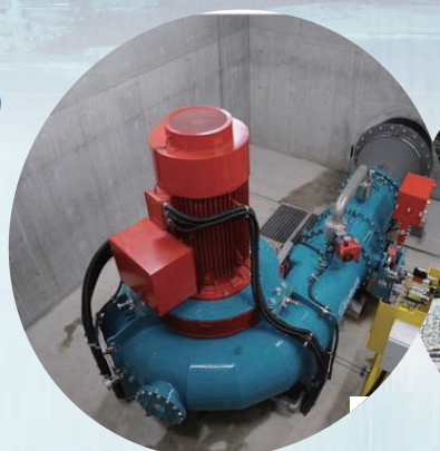
笹川小水力発電所 朝日町 196.8 kW
