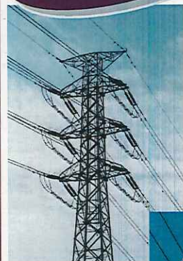
送電線は高い電圧の電気を流してありますので、電線を支える支持物は、主に鉄塔が使われています。
